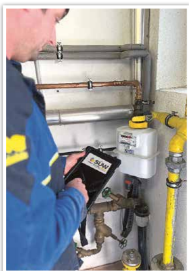
Die SÜW-Mitarbeiter brauchen freien Zugang zu den Zählern. Foto: SÜW
