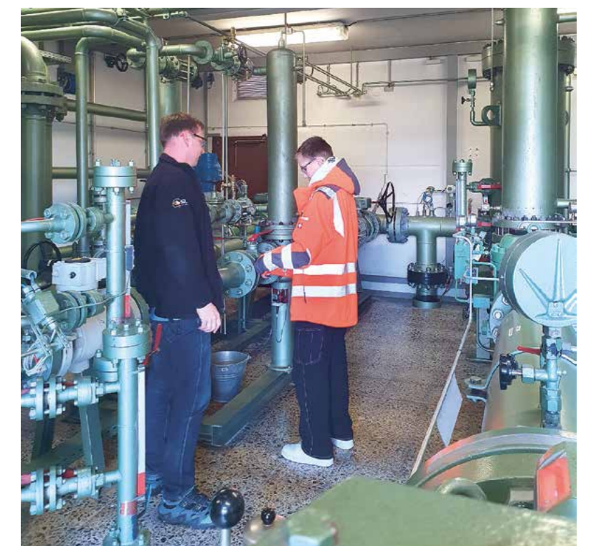
Theo und Christian Branzke, Sachgebietsleiter Gas/Wärme bei der SÜW, in der Gasdruckregelanlage.
